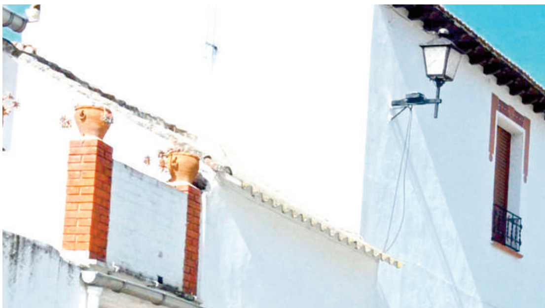
Se sustituirán las actuales luminarias provistas con lámparas de vapor de mercurio, halogenuros metálicos y vapor de sodio de alta presión, por luminarias LED más eficientes en un total de 540 puntos de luz existentes. Foto: Redacción.
