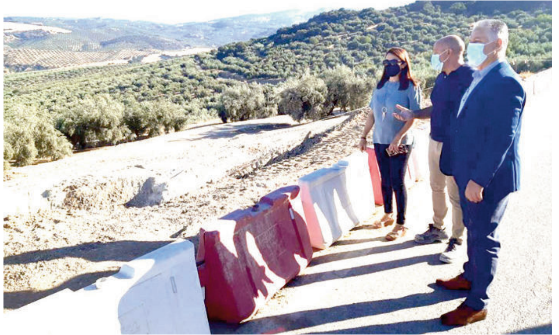
El diputado de Obras Públicas y Vivienda, José María Villegas, se ha reunido con la alcaldesa, María José Gámiz, y miembros de la Corporación provincial para conocer los detalles de la obra, cuyo presupuesto asciende a 1.092.197 euros. Foto: Redacción.
