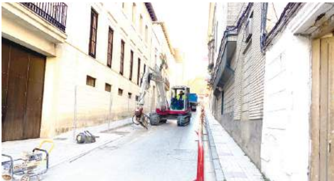
El primer tramo en que se actúa, según se marca la dirección de obra, va desde la Calle Sagrario a Calle Comedias. Foto: Redacción.
